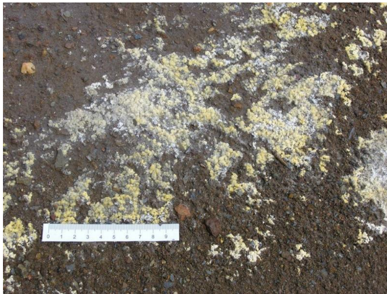
Figura 5. Ejemplo de precipitado de minerales secundarios del grupo de los sulfatos en la superficie de la presa (Figura 2). También se pueden observar en las paredes del talud y en la zanja de evacuación de la escorrentía superficial (Figuras 2, 3y 4).
